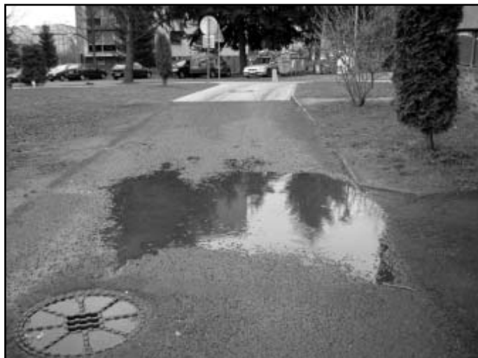
Tento kanál před domem čp. 1287 na sídlišti je evidentně nefunkční. Foto M. Pour
