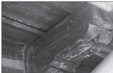
3. února 2017 - hlava trámu s původním barokním čepem
