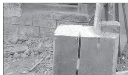
9. února 2017 tak vypadají trámy po 250 letech
