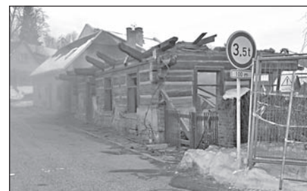
9. února 2017 poslední záběry, i na řezech v trámech je vidět dobrý stav dřeva
