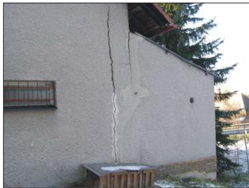
Původní stav přístavby: hrozilo její zřícení, na několika místech bylo zdivo tak potřhané, že mezerami bylo možno prostrčit dlaň ruky.
