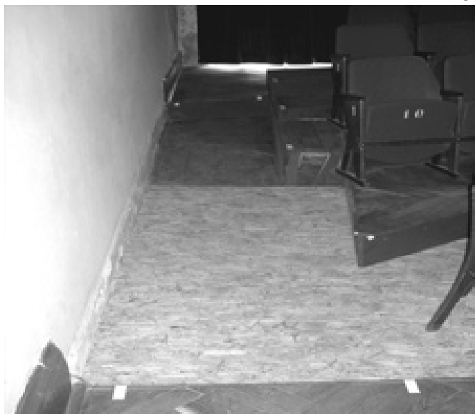
část podlahy napadené dřevomorkou - balkón
