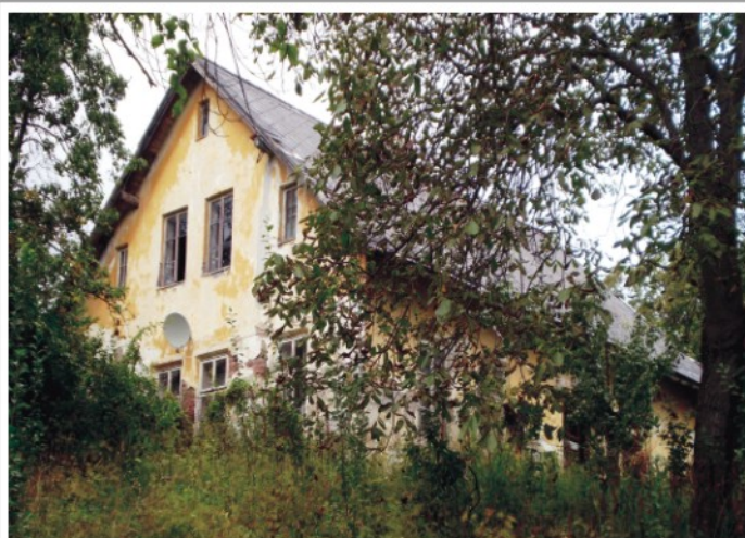
Objekt čp. 120, na krásném místě, ale nyní prázdný, neobydlený a chátrající.
