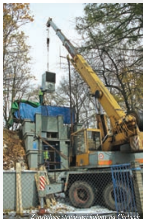
Z instalace stripovací kolony na Chrbech
