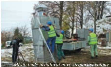
Město bude instalovat nové stripovací kolony
