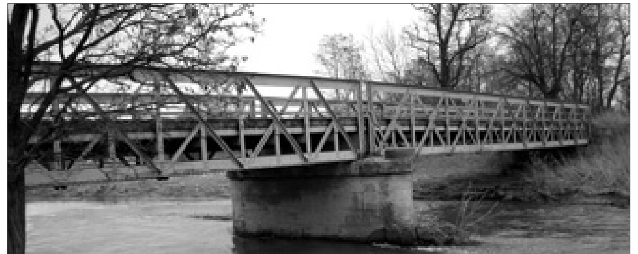
Odnese ho příští jaro velká voda, nebo spolyká koroze?
