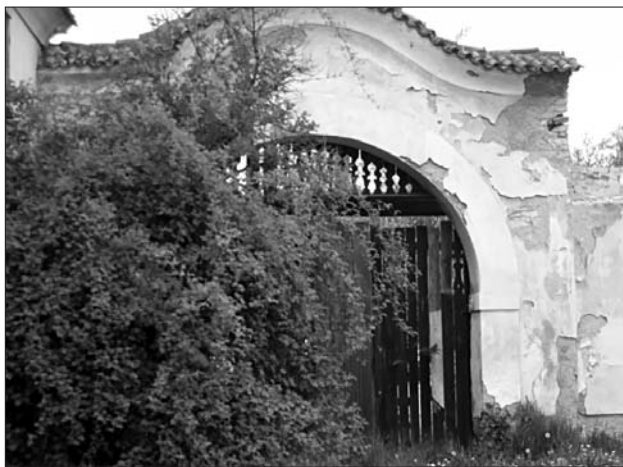
Barokní brána do dvora u Cidliny si zasloužila opravu, ale byla stržena.
