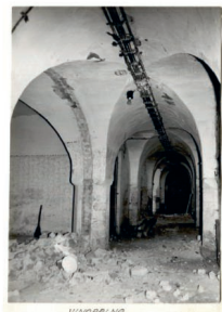
Zbytky původních bytů v bývalé vinopalně
