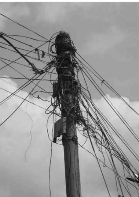
Sloup elektrického vedení na nigerijský způsob.
