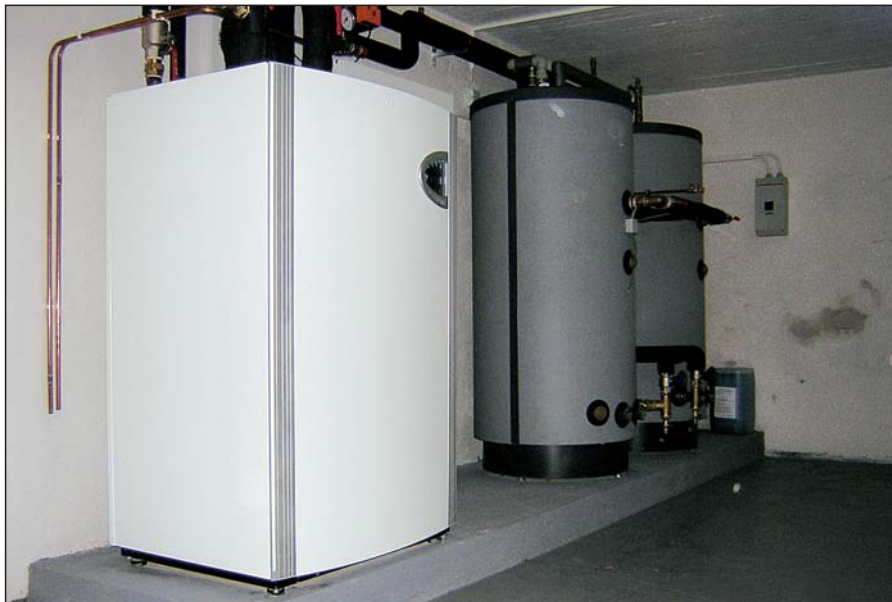
Nová kotelna v kulturním domě s tepelným čerpadlem
