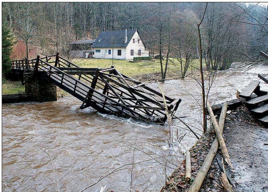
Poničená Boušínská lávka – březen 2008
