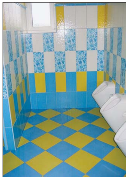
Nové WC v základní škole
