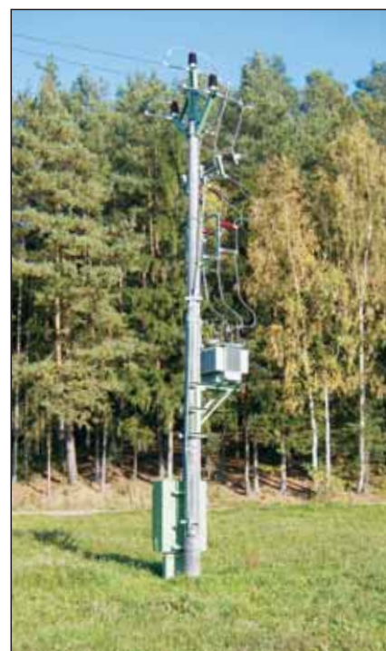
Nová sloupová trafostanice pod Brandeburkem
