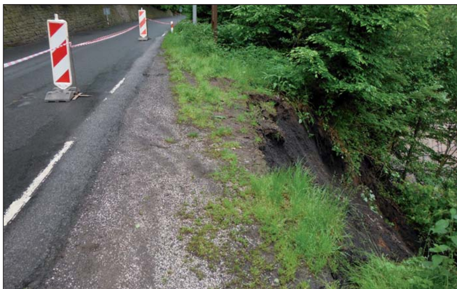
Podemletý a utržený svah u hlavní silnice v Habřině
