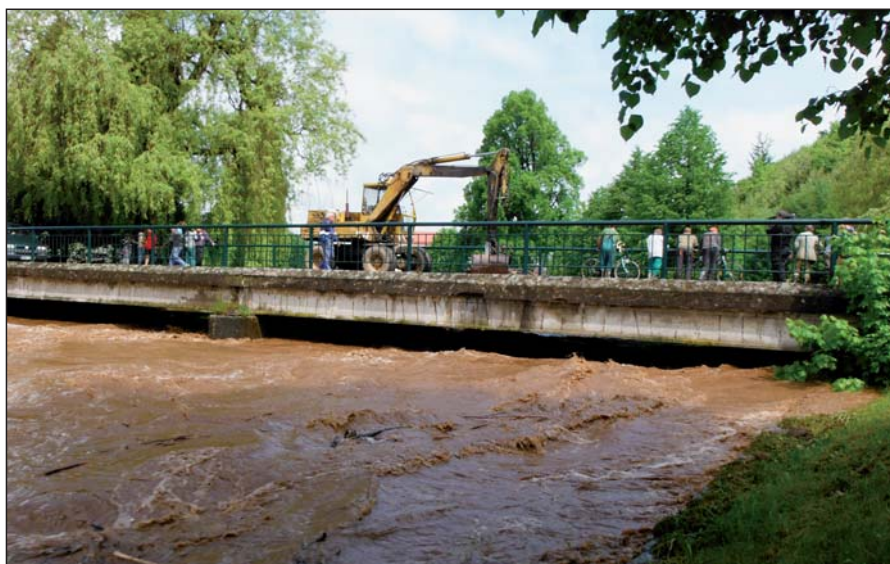
Velká voda se ještě vešla pod betonový most
