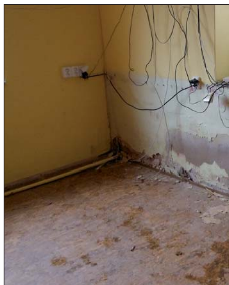
Vlhké zdivo po odstranění dřevěného obložení
