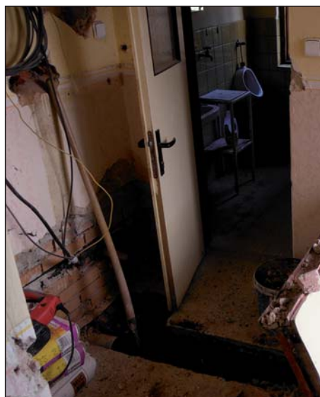
Původní WC byly přebudovány na technickou
