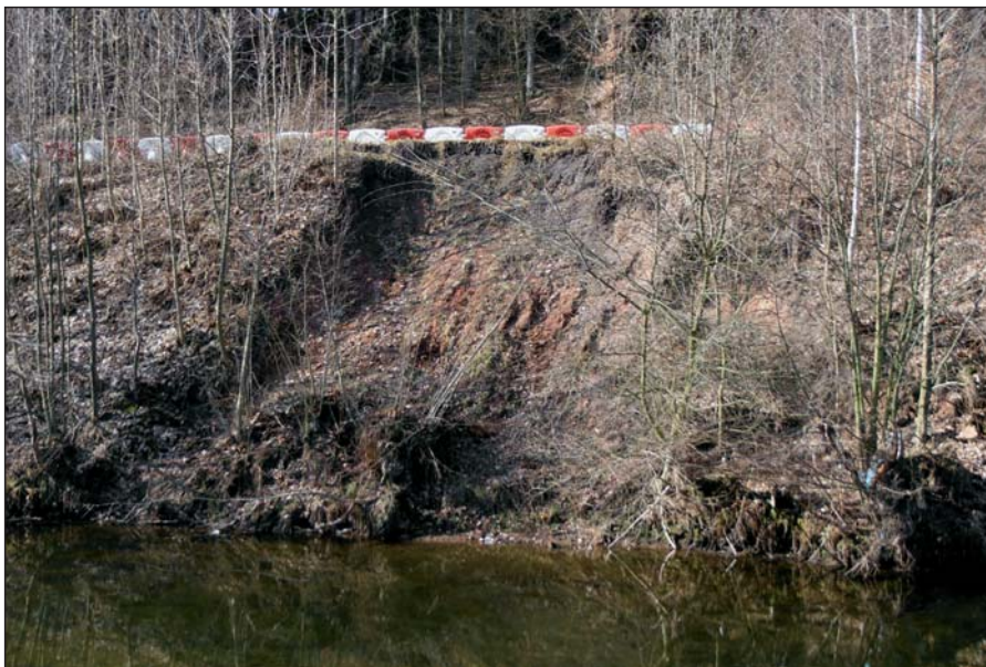
Sesuv svahu v Habříně způsobila povodeň v roce 2013
