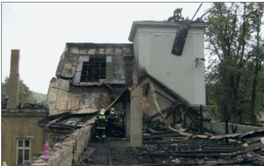
Dohašování rozsáhlého požáru zámku v Horním Maršově
