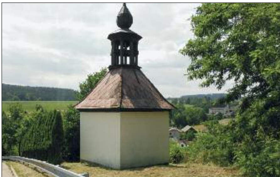
Zdánlivě pěknou zvoničku čekala kompletní rekonstrukce
