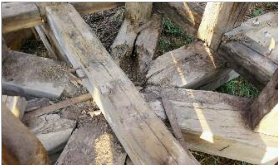
Původní krov napadený hnilobou a škůdci
