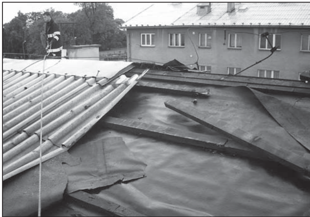
☐ Zabezpečení větrem poškozené střechy na Sídlišti 1. máje.
