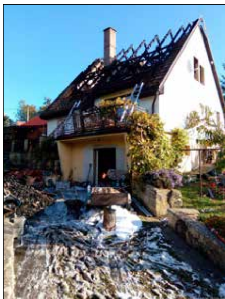
10. 10. 2016 / Chyjice / Požár rodinného domu
