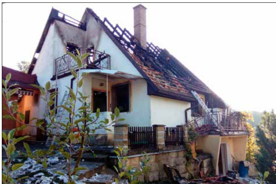
Miliónové škody způsobené nočním požárem. Obyvatelům domu se naštěstí podařilo na poslední chvíli uniknout oknem. (Chyjice 10. 10. 2016)
