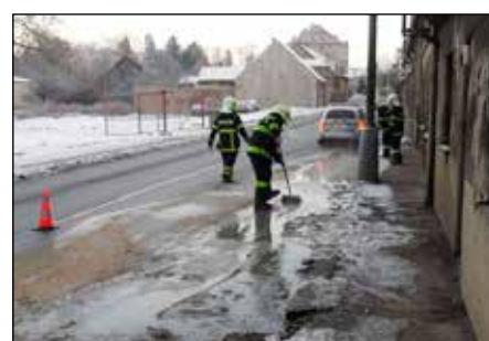
7. 1. 2017 / Kopidlno / Prasklé vodovodní potrubí
