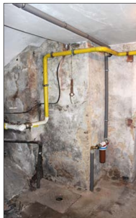
Správně zateplené potrubí.
