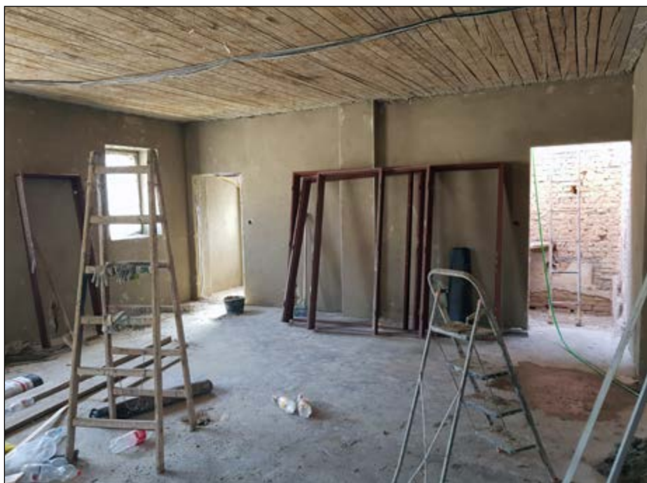
Instalovaná kabeláž (uprostřed stropu).
