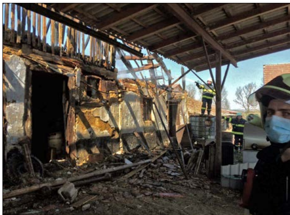
7. 4. 2020 / Chotěšice – Malá Strana / Požár dřevěného domu
