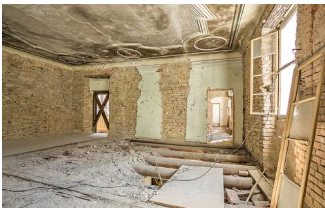
Zvenčí budova čp. 2 ostudu Trčkovu náměstí rozhodně nedělá. Pokud však nahlédnete dovnitř, už je to mnohem horší.
