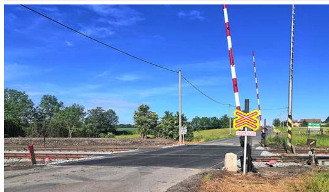
Přejezd už opravu nutně potřeboval.
