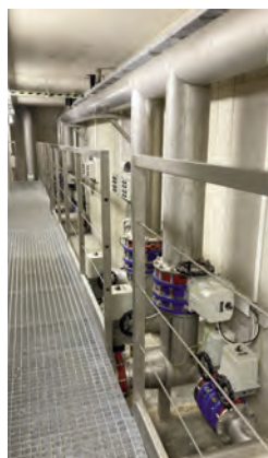
Úpravna vody v Rychnově nad Kněžnou dodává lidem pitnou vodu ve špičkové kvalitě. Foto: Vak RK
