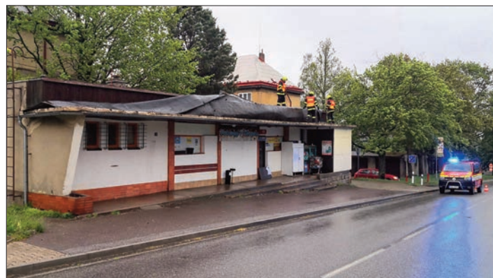
Z výjezdu č. 17-20 – uvolněná střešní krytina na obchodu v Malých Svatoňovicích
