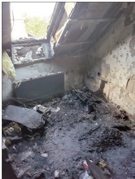
Z výjezdu č. 25 – požár rodinného domu ve Velkých Svatoňovicích
