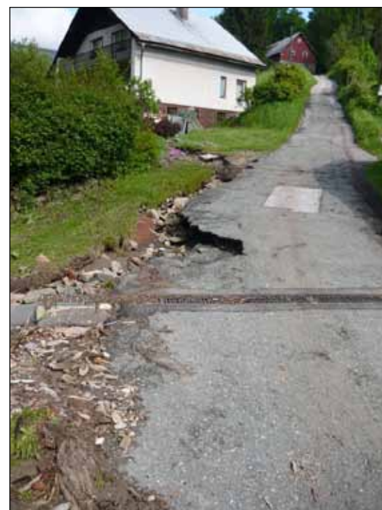
Zničená komunikace Pod Světlou horou v Maršově II
