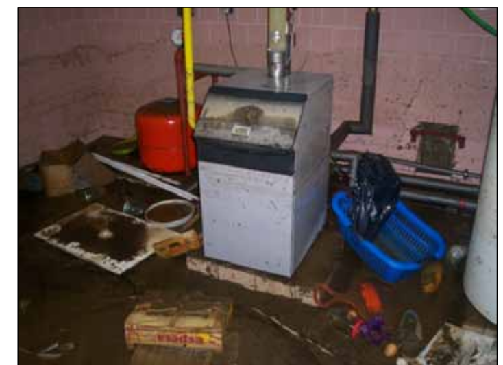
Kotelna v mateřské školce ve Svobodě po povodni
