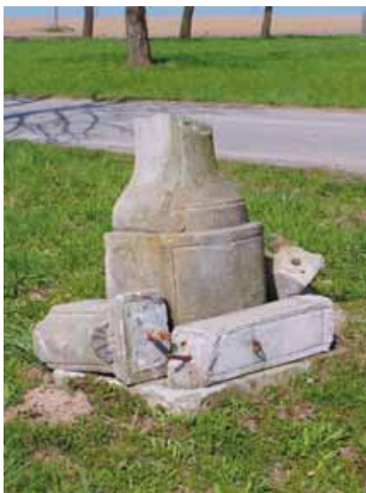
Socha – kříž ve Vamberku, havarijní stav, foto z r. 2004
