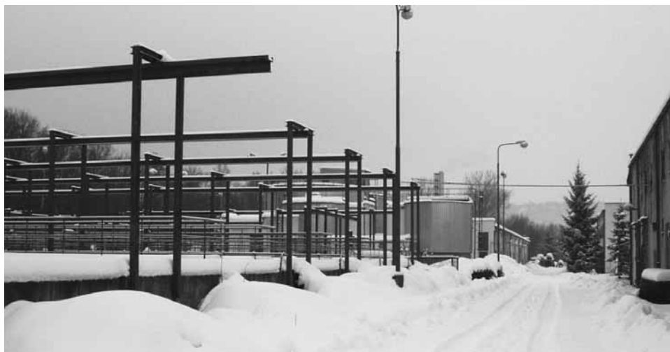
■ Vlevo aktivací nádrže, dále jímky stabilizovaného kalu (na fotografii nejsou vidět), za nimi zásobníky na kal, úplně vzadu garáže, dílny, sklady.
