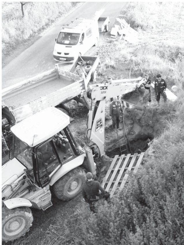
Porucha vodovodního řadu v Pekle 11.06. - 12.06.2013
