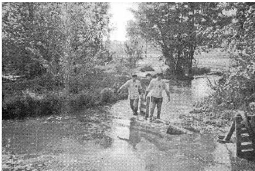
Špinavé vody bylo k čerpání všude hodně
