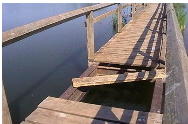
Část vandaly poničené lávky na písáku Obora. Její oprava bude stát cca 20 tis. Kč.
