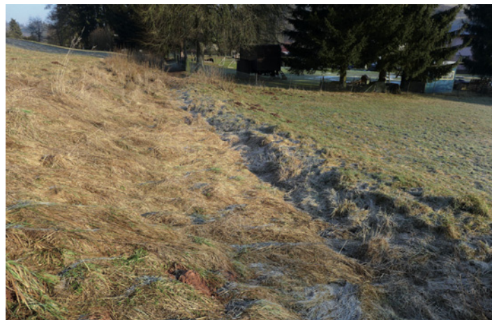
Jeden z mála dochovaných, byť již zarůstajících úseků kanálu nad Špitálskou ulicí pod čp. 170 a 173.
