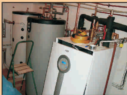
Tepelné čerpadlo v MŠ Prostřední Lánov. Stejně je v ZŠ budově „B“.
