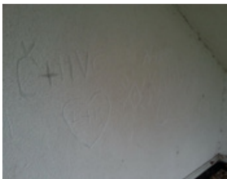
Poškozená zeď v Geriatrickém centru.
