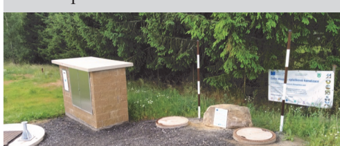
Přečerpávací stanice na Zadním Mostku
